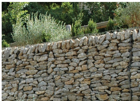
► Soutènement réalisé en gabions - Mercuès (46) - «un pour cent paysages» paysagistes
